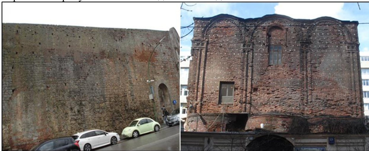
Рисунок 2 – Разрушение кирпичной кладки исторических зданий из полнотелого красного кирпича: Крепость св. Варвары (вторая пол. XVI века), г. Сиена, Италия (слева); и Храм Рождества Пресвятой Богородицы в Бутырской слободе (1682–1684 гг.), г. Москва, Россия (справа)
