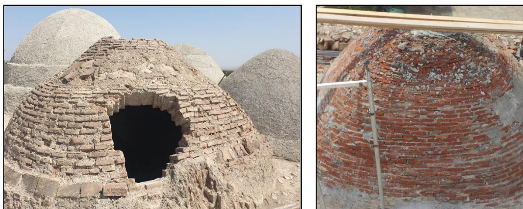
Рис 3. Характер повреждений купола до и после перекладки.
